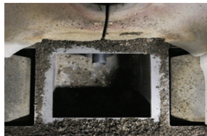
Espace sous le brûleur
